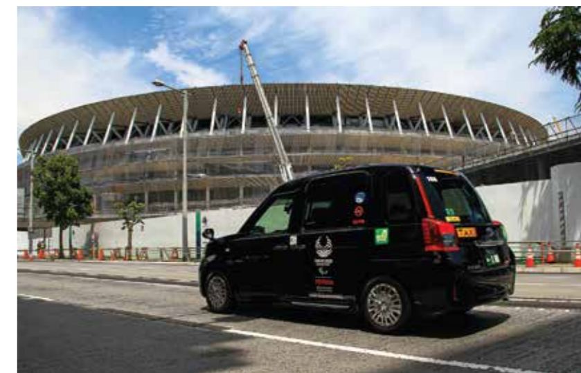
Se culminó el techado del Nuevo Estadio Nacional de Tokio, según dicen, la parte más difícil de la obra, mezcla de madera y marcos de acero. El flamante Estadio Olímpico debe entregarse en noviembre próximo.
